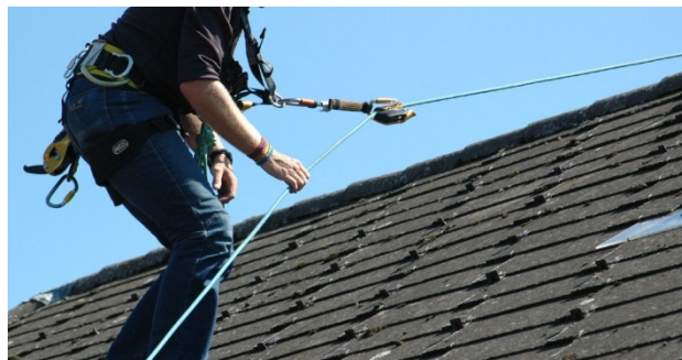
1 Bereits bei der Massaufnahme besteht Absturz- oder Durchbruchgefahr. Eine fachgerechte Sicherung ist unumgänglich.
